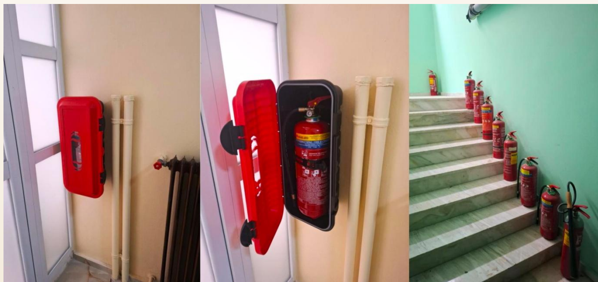
Εικόνα 3. Μέσα πυρόσβεσης εγκαταστάσεων
